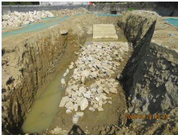
图 12 三溪河综合整治工程上禾塘支流段基坑临边防护缺失。
