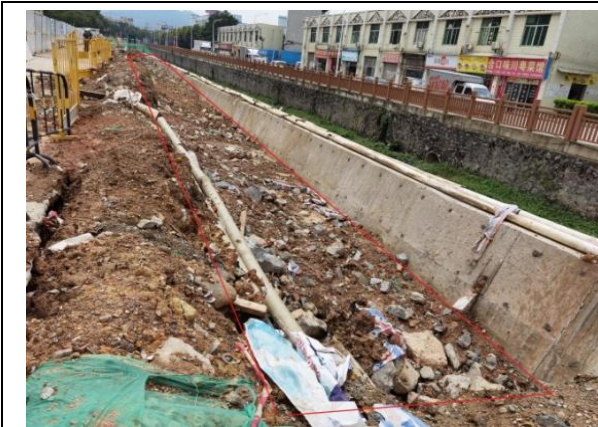
图 2 观澜河流域水环境综合整治工程-鹅公岭河综合整治工程 9#节点挡墙后回填土料夹带块石、建筑垃圾等杂物，且未按要求分层回填压实。
