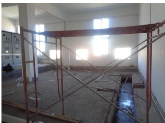
图 13 孖庙涌排涝泵站工程现场简易门字架作业层脚手板未满铺，四周缺少防护。
