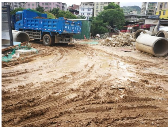
图 8 2019 年龙岗区深圳河流域消除黑臭及河流水质保障工程场区道路积泥、无车辆自动冲洗设施。
