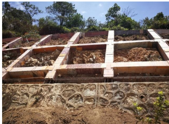
图 11 洞梓水库库周边坡整治工程 9#~11#边坡整治斜坡施工未设置施工操作平台，也无安全防护措施，且坡度较陡，现场边坡施工无人员上下通道。
