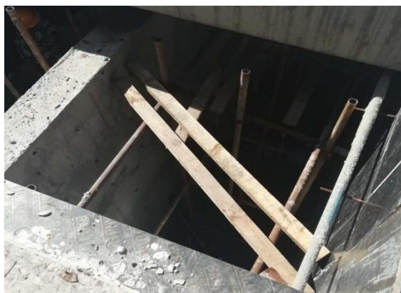
图 12 深圳市荔枝湖水环境综合治理工程水循环处理系统部分洞口无临边防护，工作平台未满铺。
