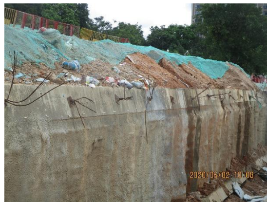
图 9 白芒河流域水环境综合治理工程（初雨处理设施除外）调蓄池临边堆土距沟槽边缘小于 0.8m。
