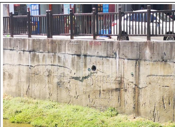
图 3 大空港片区水环境综合整治项目-坳颈涌综合整治工程 AJ2+780~AJ2+973 段混凝土挡墙存在蜂窝、麻面、错台等质量问题。
