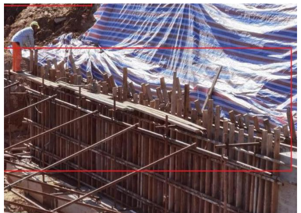
图 13 观澜河流域水环境综合整治工程-木古河综合整治工程 2 标施工脚手架作业层未铺满脚手板、未设置安全防护栏杆。
