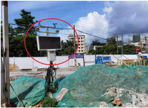
图 8 观澜河流域水环境综合整治工程-山厦河综合整治工程现场 TSP 未正常显示。
