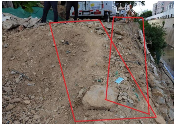
图 11 观澜河流域水环境综合整治工程-山厦河综合整治工程 8 节点部分边坡无临边防护措施，现场边坡无人员上下通道。
