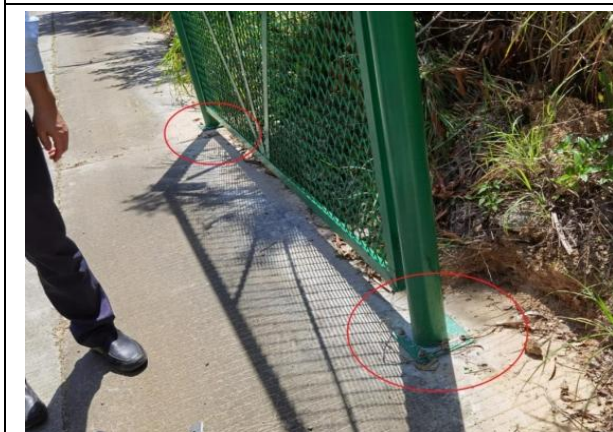
图 6 铜锣径水库隔离围网完善工程 B 段围网立柱基础现场采用螺栓固定在混凝土路面上，与设计要求的立柱基础不符。
