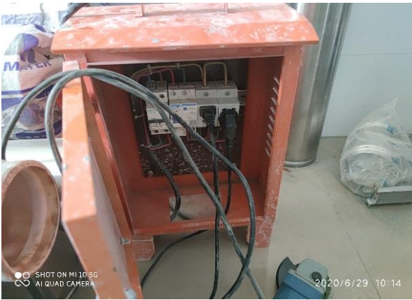
图 10 盐田区居民小区二次供水设施改造工程蓝色海月居开关箱内一个漏电保护器控制二台施工机具。
