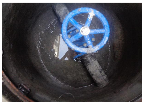
图 7 罗湖区 10 项管网改造工程向西村给水检查井底部未设置集水坑、阀门底部未设置支墩。
