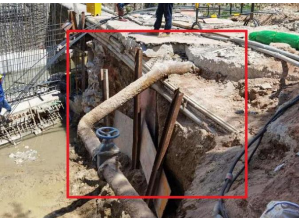
图 12 同乐河综合整治一期工程-桥梁部分边坡未按照设计要求支护（设计要求 9m 长的钢板桩支护）。
