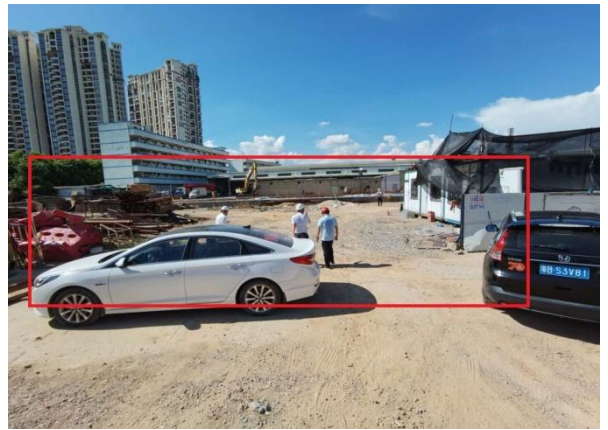
图 9 观澜河流域水环境综合整治工程-木古河综合整治工程 2 标 8 节点施工现场存在多个与外界交叉部位无封闭隔离措施，施工区域进出口未设置车辆冲洗装置。
