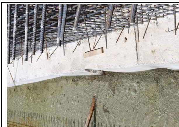
图 2 同乐河综合整治一期工程-桥梁部分 13#桥段左侧截污管包封混凝土的外观存在局部胀模、轮廓线不顺直等质量缺陷。
