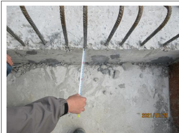
图2 同乐河综合整治一期工程-桥梁部分29#箱涵顶预埋护栏钢筋保护层厚度不足。
