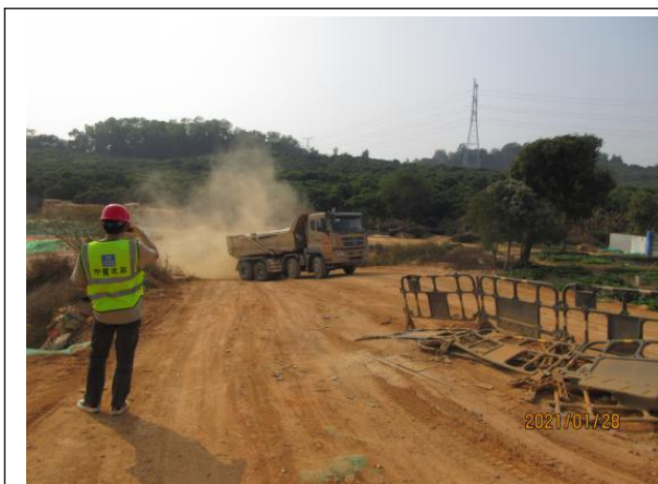
图 8 白芒河流域水环境综合治理工程（水质保障工程）河道右侧未及时洒水，施工现场扬尘较大。
