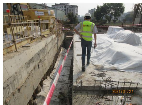
图 13 观澜河流域水环境综合整治工程-山厦河综合整治工程 8#节点 10#桥涵临边防护使用警戒带围蔽，未使用硬质安全防护栏杆。
