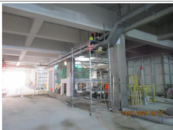
图 12 深圳市埔地吓水质净化厂三期工程设计采购施工总承包（EPC）移动式脚手架脚手板未满铺，高宽比大于 2:1，内侧无防护栏杆。
