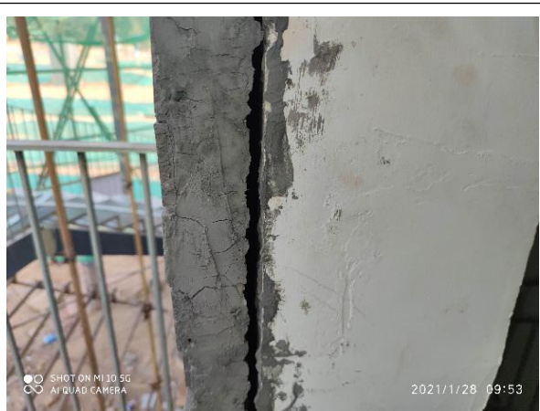
图3 深圳市洪湖水质净化厂一期工程风井外墙砂浆面脱空。
