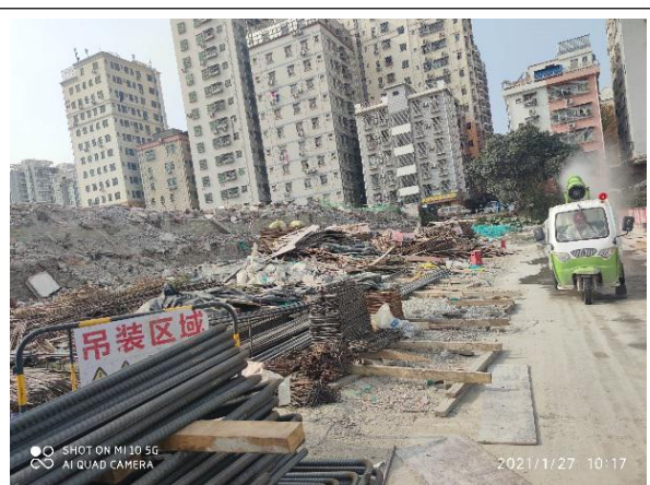
图 9 民治地下水水质净化厂 BOT 项目现场材料堆放混乱，钢筋堆放无防雨、防潮措施。
