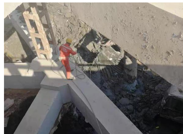
图 11 大空港新城区截流河综合治理工程-主体部分（不含生态修复）基坑混凝土水平支撑梁上作业人员无安全防护措施。
