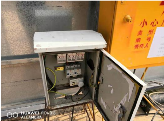
图 14 埔地吓水质净化厂一期提标改造工程现场临时用电存在“一箱多机”、相零线混用等安全隐患。
