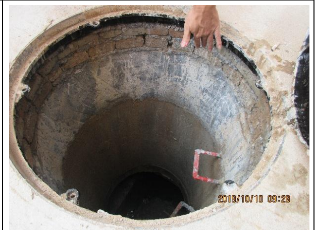
图 7 小区排水管网改造工程（第四批）-观澜街道检查井内壁抹灰质量较差，局部未抹灰。
