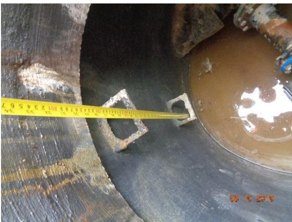
图 10 坪山区社区供水管网改造工程（七期）朱青路阀门井踏步未错开且间距偏大（设计要求踏步水平间距 30cm，上下间距 36cm，现场实测上下间距 53cm）。
