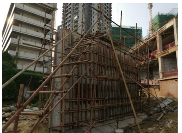
图 17 保安片区城市更新单元一期东片区蚌湖水综合整治工程挡墙施工脚手架未按照专项施工方案搭设, 且未经验收即投入使用。
