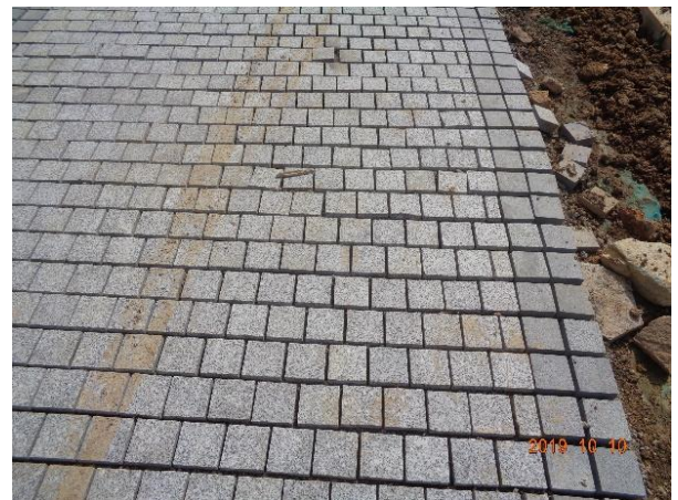
图 11 坝光片区防洪（潮）排涝工程江屋山水砖砌块铺地拼缝大小不一（设计拼缝宽度为 5-8mm，现场实测最大 18mm）。
