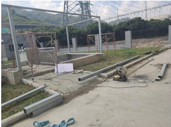
图 12 茅洲河(光明区)水环境综合整治工程项目-河道底泥处理厂建设工程现场部分材料堆放较乱, 材料工具摆放阻塞施工通道或缺少施工安全通道。
