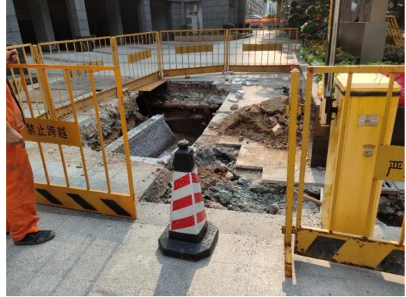
图 13 福田区 3 项给水管网改造工程(施工)施工现场围挡未封闭, 缺少安全警示标志和夜间警示灯。
