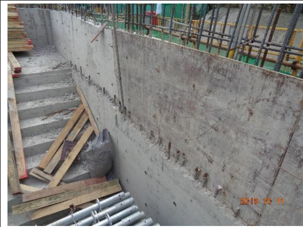
图 6 深圳洪湖水质净化厂一期工程精细格栅 9、10 层处墙体钢筋露筋（下面层钢筋下料过长）。
