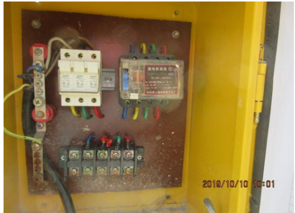
图 15 坝光片区防洪(潮)排涝工程大坑槽水干流段抽水水泵控制开关箱相线颜色未做区分, 配电箱未重复接地。
