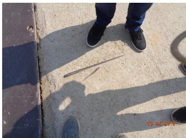
图 5 同乐河综合整治一期工程-桥梁部分 11#长围路桥涵洞一侧顶板二处露筋，混凝土表面夹模未清理。
