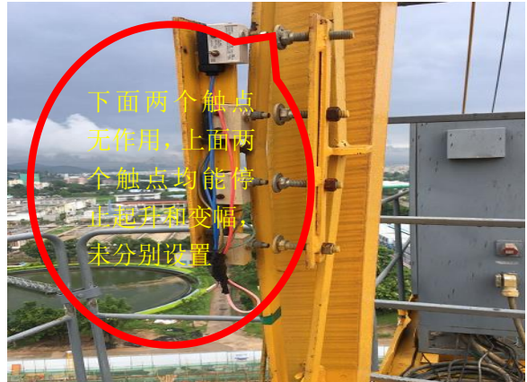
图 9 横岭水质净化厂二期提标改造工程塔吊本体起重力矩限制器控制定码变幅的触点和控制定幅变码的触点未分别设置。
