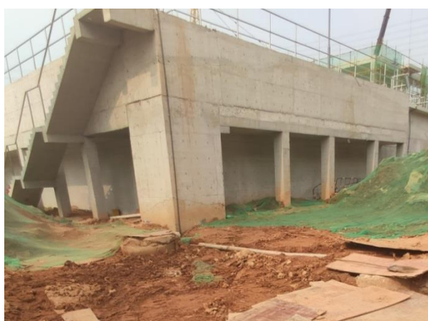
图 6 公明、松岗水质净化厂一期提标改造工程沉淀池、曝气池等结构混凝土外观较差，存在错台、冷缝。
