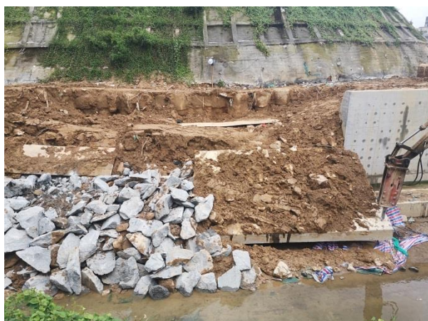
图 4 石岩河综合整治工程（一期）第二标段桩号 SYH3+256 ~ SYH3+271 段混凝土挡墙发生倒塌事件。
