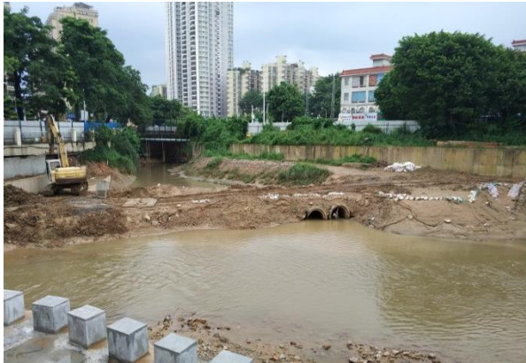
图 10 沙湾河干流筒竹河河口段设置的施工围堰，缩窄了河道过流断面，影响河道汛期正常行洪。
