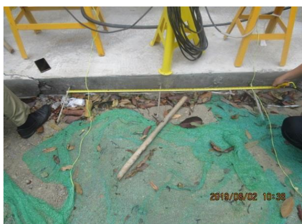
图 7 宝安区 2019 年全面消除黑臭水体工程（大空港片区）一一工区福园一路现浇混凝土面层纵向拉杆钢筋间距不符合设计要求。
