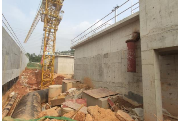
图 11 公明、松岗水质净化厂一期提标改造工程，建筑垃圾、生活垃圾满地，救生圈随意丢弃；开挖土方随处堆放，未及时清运。
