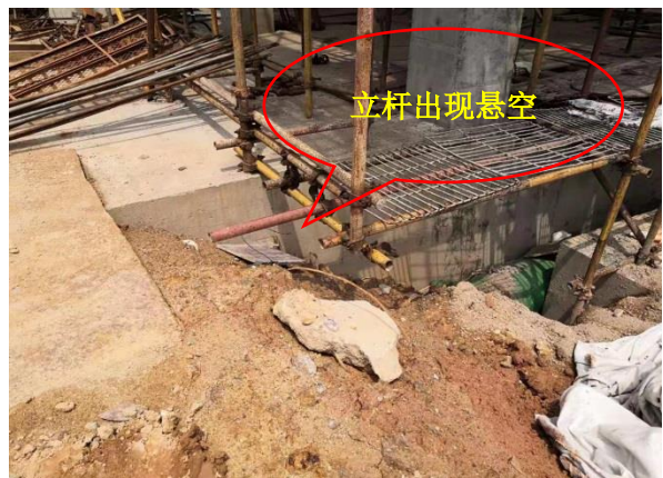
图 13 宝安沙井河片区排涝工程（一）外脚手架个别立杆悬空。
