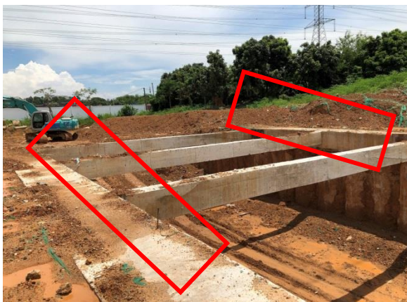
图 12 白泥坑水综合整治工程 5#节点箱涵基坑无临边防护，无人员上下通道，违规使用竹梯上下基坑。
