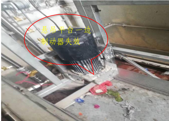
图 8 福田区第四期（2016-2017 年度）优质饮用水入户工程（梅林三村）95312#吊篮作业现场悬吊平台一边制动器失效。
