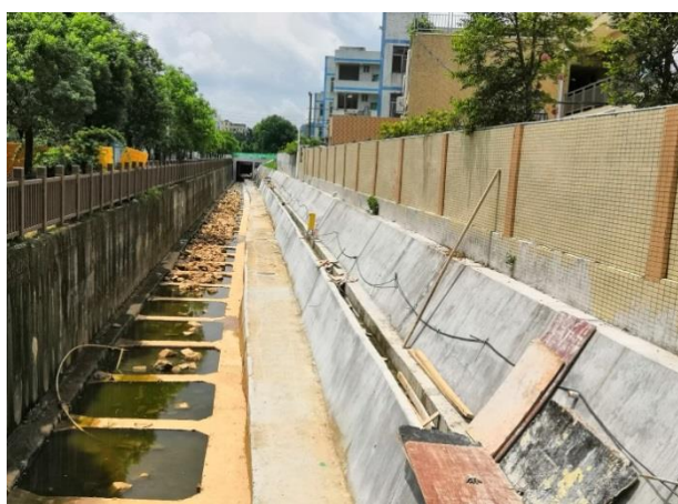
图 4 龙岗河流域河道综合整治项目 EPC (设计采购施工) -新生排水渠综合整治工程右岸挂板施工外观质量较差, 线型不顺直, 存在跑模现象。
