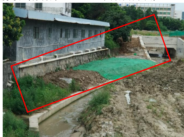
图 7 龙岗河流域河道综合整治项目 EPC (设计采购和施工) --花园河综合整治工程坪西北支流 N6#过路涵施工区管道回填土未分层压实和检测。
