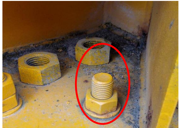
图 9 坝光水质净化厂回转支座一螺栓单螺母固定。
