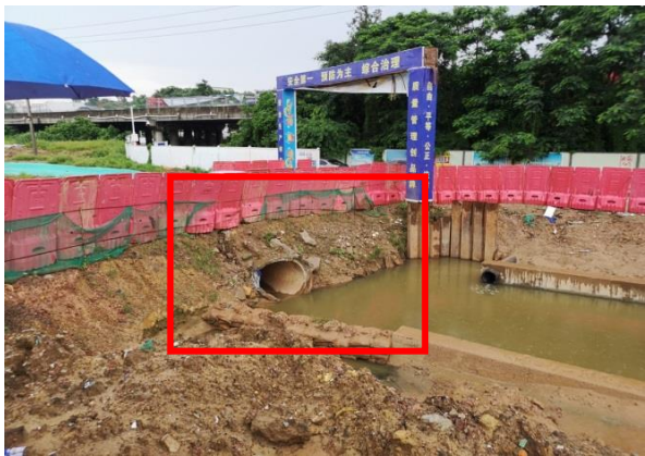
图 10 龙岗河流域河道综合整治项目 EPC (设计采购施工)-上禾塘水综合整治工程 2 号节点施工便桥处仅用 1 根涵管进行施工导流, 影响河道汛期的正常行洪。
