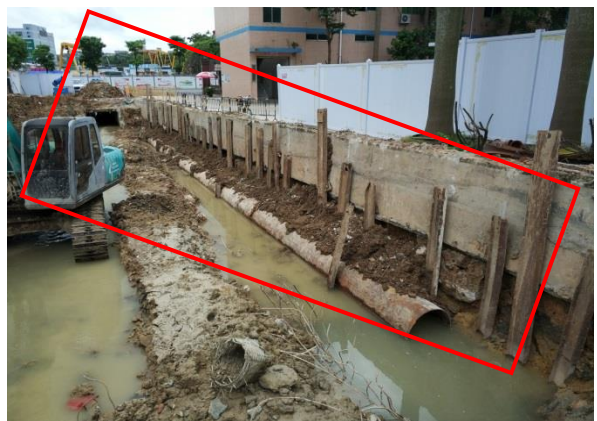
图 13 龙岗河流域河道综合整治项目 EPC (设计采购和施工)-花园河综合整治工程坪西北支流 N1#过路涵施工未按设计要求采用微型桩支护; 围墙混凝土基础局部掏空, 存在安全隐患。
