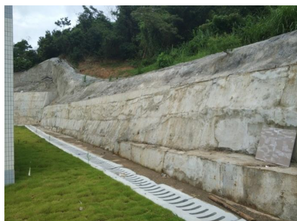
图 5 大鹏新区社区给水管网改造工程 (五期) 雷达站提升泵房后混凝土挡墙外观质量差, 局部混凝土表面存在错台、蜂窝、平整度差等外观质量缺陷挡墙上部护坡喷砼厚度达不到设计要求 (100mm), 局部出现开裂现象。
