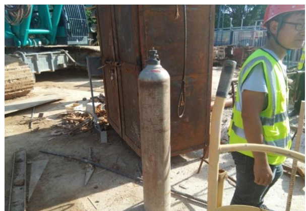
图 11 白芒河流域水环境综合治理工程(水质保障部分)施工现场氧气瓶未按规定要求存放, 裸露在室外下阳光暴晒, 存在安全隐患。
