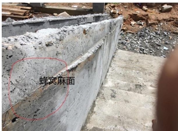
图 6 坂雪岗水质净化厂二期工程一号楼梯混凝土混凝土表面存在多处外观质量缺陷。
