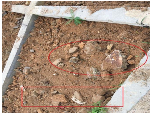
图6 新大河综合整治工程泛洪区格构梁护坡回填土料中夹带石块、建筑垃圾等杂物。
