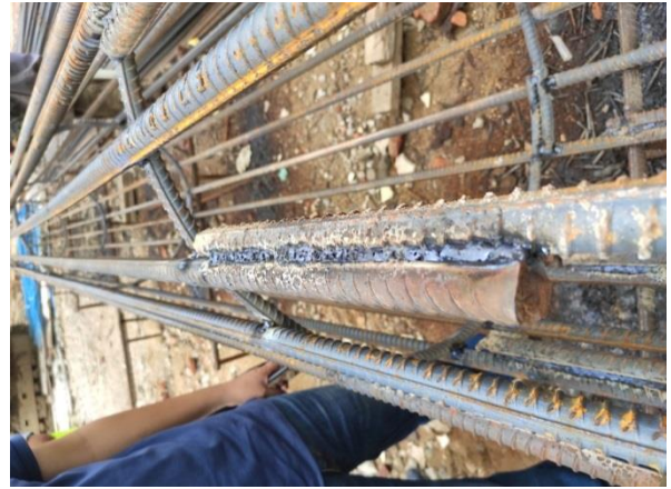
图5 茅洲河支流排洪渠综合整治工程钢筋笼钢筋搭接单面焊长度不满足规范要求，存在夹渣、咬边现象。
