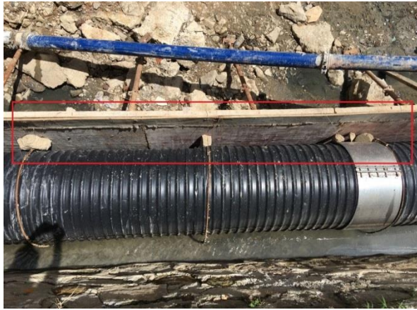
图4 四联河地面坍塌隐患治理及水环境综合整治工程截污管外包混凝土模板安装不规范，外包混凝土厚度不均匀，局部达不到设计要求（设计要求厚度为20cm）。
