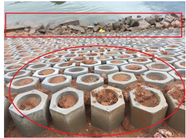
图7 新大河综合整治工程入海口段螺母块摆放不紧凑，缝宽过大，干砌石护脚砌筑不密实、不平整，存在大量孤石和浮塞现象。
