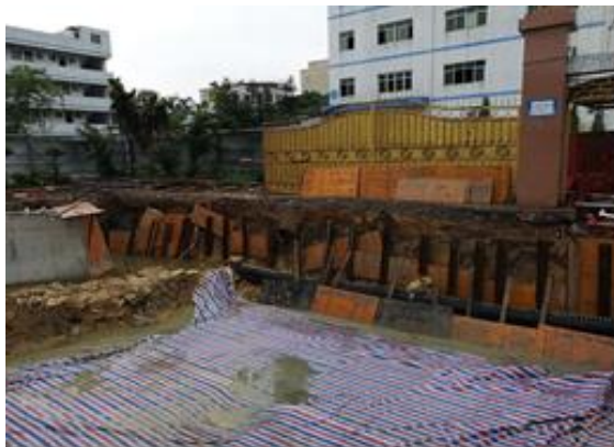
图 14 龙岗河流域田脚水综合整治工程 21 号箱涵边坡开挖未按设计要求(坡比 1:1)放坡开挖; 现场采用的支护措施不规范, 存在一定安全隐患; 河道内存在横纵向堆土围堰, 影响河道汛期的正常行洪。
