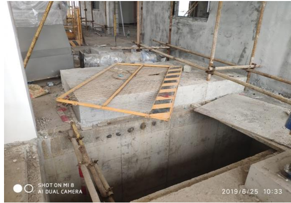
图 11 观澜水质净化厂提标扩容工程-二期临边防护有缺失。
