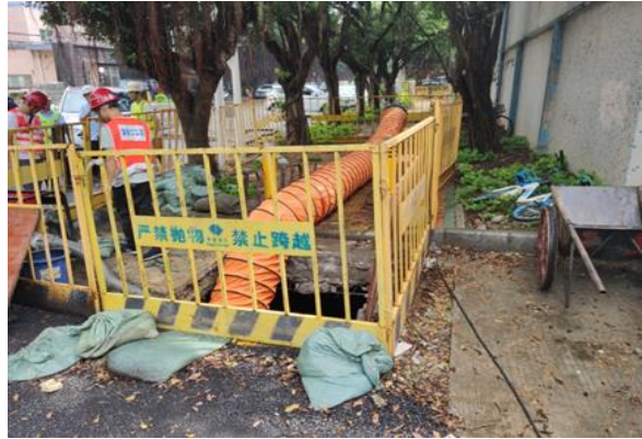
图 13 2019 年宝安区全面消除黑臭水体工程(茅洲河片区)二工区 隐患: 暗涵清淤施工现场缺少有限空间作业危险告知相关警示标识。
