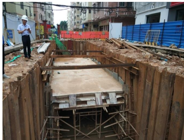
图8 田心村排水渠综合整治工程6#节点K1+000段箱涵基坑开挖断面尺寸与设计不符，箱涵侧墙与拉森钢板桩间距不足10cm，不满足设计1.5m要求。
