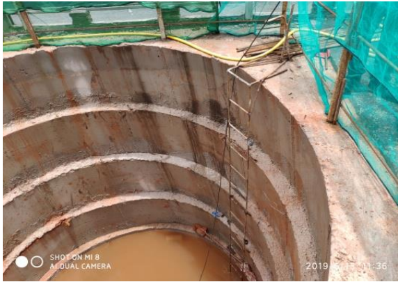
图 10 环观中路-人民路水管网改造工程工作井爬梯未设置护笼。
