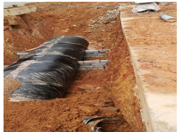
图9 观澜水质净化厂提标扩容工程-二期工程反硝池南面东侧已埋设约10米的钢管（直径2.6米）管道基础未按设计要求进行施工。
