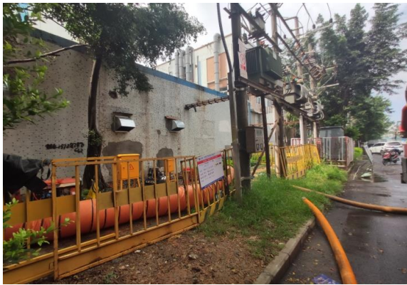
图 12 2019 年宝安区全面消除黑臭水体工程(茅洲河片区)二工区作业区域临近变压器, 变压器缺少防护措施和警示标识。
