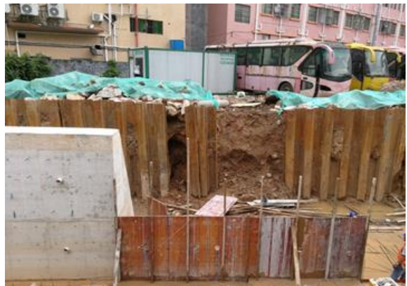
图 15 茅洲河支流排洪渠综合整治工程左岸钢板桩支护未按施工方案实施且不连续、未封闭, 出现土体塌落, 钢板桩支护已出现较大水平位移, 存在安全隐患
