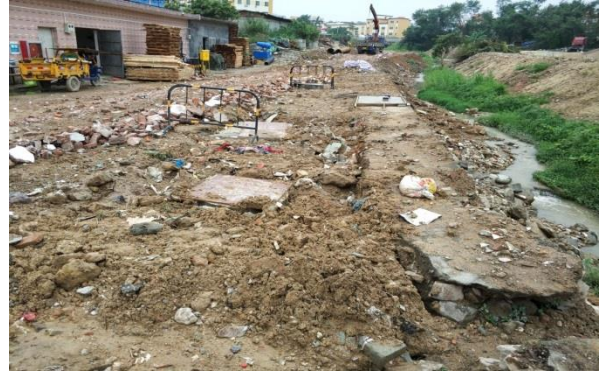
图 10 黄竹坑水综合整治工程 C 段施工区已完成的 210m 截污管回填料夹带建筑垃圾，且未分层夯实、分层检测。
