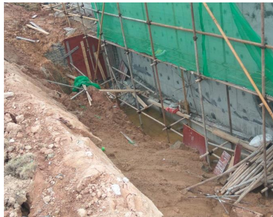
图 14 龙华水质净化厂（一期）提标改造工程——脚手架基础未夯实且部分位置有积水；立杆底部垫木宽度、厚度不符。
