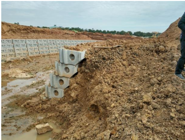
图 7 同乐片区 23-1 基本农田排洪渠整治工程干流河道边坡设计要求采用“土钉+喷射砼支护”施工；干流河道框式生态挡墙墙后回填未按设计要求 2m 以下分别采用碎石、砂回填，现场实际采用土料回填。
