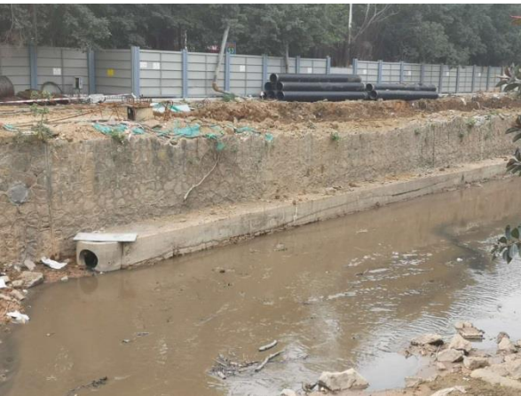
图 11 大空港片区水环境综合整治项目-坳颈涌综合整治工程：截污管涵包封混凝土存在错台、冷缝、蜂窝麻面等质量问题。
