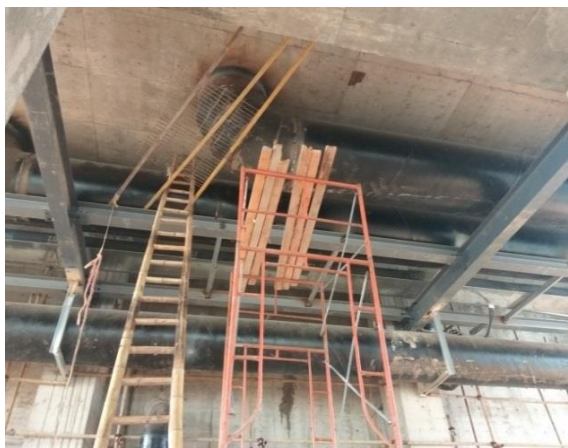
图 15 观澜河口调蓄池提标改造工程——生化池进水管施工区作业平台用木方代替脚手板且未铺满、未固定、未设置。
