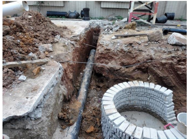
图 8 坪山区社区供水管网改造（五期）未铺设砂垫层，管沟开挖宽度达不到设计要求。
