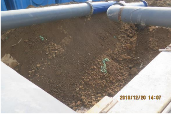
图 9 横岗水质净化厂（一期）提标改造工程管道未按设计要求分层回填。
