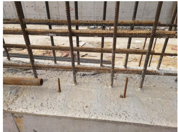
图 12 前海铁石片区水环境综合整治项目-固戍涌综合整治工程凿毛不彻底，钢筋间距不足。
