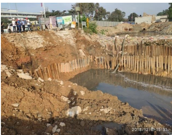
图 17 大空港片区水环境综合整治项目-灶下涌综合整治工程——基坑开挖及支护未制定专项方案和进行专家论证。
