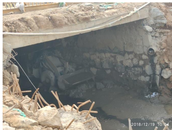
图 18 2018 年 12 月 18 日 930 左右，塘尾涌综合整治工程施工人员在福海街道塘尾社区松福大道发生机械伤害事故，装载机司机经送医院抢救无效死亡。
