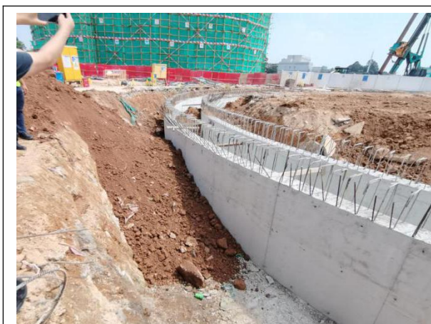
图2 罗田水库-铁岗水库输水隧洞工程导墙侧面沟槽回填土未分层回填、分层压实，回填土中含有建筑垃圾。
