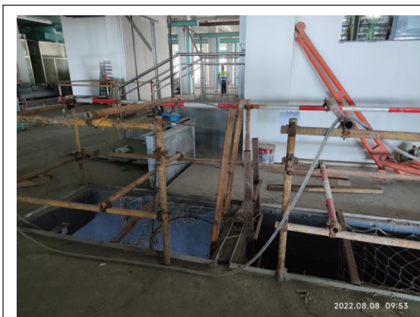
图6 福永水质净化厂二期工程设计采购施工总承包（EPC）生物池负一层内有限空间作业出入口缺少相关警示标识。
