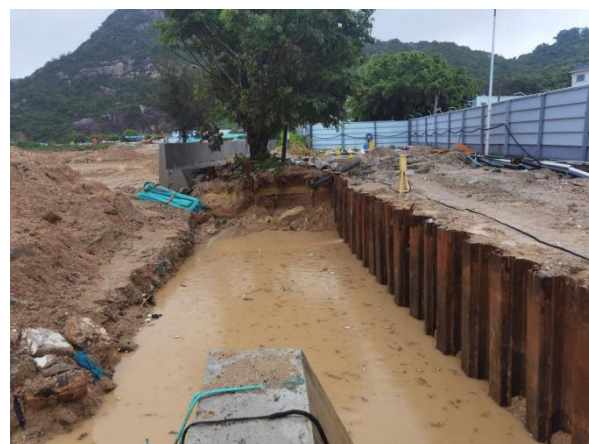
图7 深圳市东部海堤重建工程（三期）水工施工总承包工程（I标段）东山段施工现场的部分临边无防护措施。
