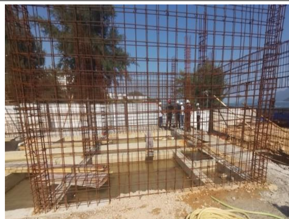
图3 深圳市东部海堤重建工程（三期）堤岸配套景观工程（III标段）卫生间绑扎钢筋锈蚀严重。
