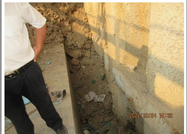
图5 大空港新城区截流河综合治理工程-主体部分(不含生态修复)箱涵回填石粉渣未分层,箱涵两侧未按设计要求回填石粉渣。
