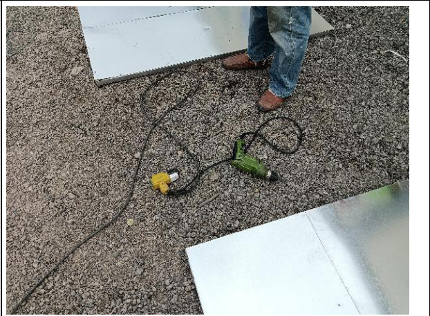
图 11 西丽水库至南山水厂原水管工程施工总承包现场使用活动插座, 电缆线拖地。
