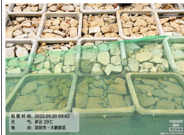
图4 王母河水环境综合整治工程部分砌石石料尺寸偏小,砌石表面平整度不佳。
