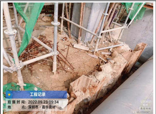
图 9 深圳市沙井水质净化厂三期工程设计采购施工总承包 (EPC) 高支模立杆下端支撑在软土上、局部悬空。
