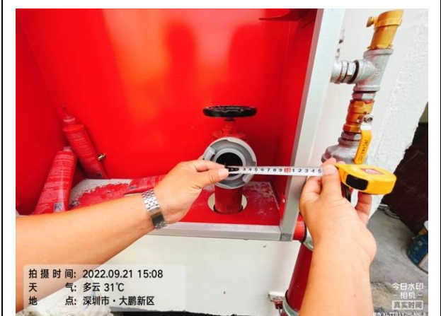
图7 径心水库附属设施隐患整治及环境提升工程宿舍楼二楼地面铺装砂浆层偏厚,消火栓阀门中心距箱侧面离偏小。
