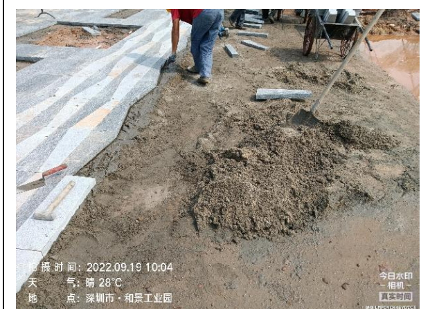
图6 大空港新城区截流河综合治理工程沿河休闲带景观及2座人行天桥项目示范段工程现场瓷砖铺装使用自拌砂浆,无配合比,部分砂浆成团结块。
