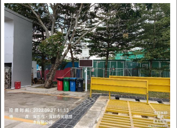
图 13 罗田水库-铁岗水库输水隧洞工程公明检修井工地在线扬尘检测系统未开启。。
