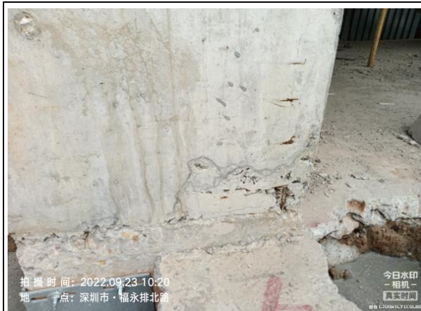
图2 福永水质净化厂二期工程设计采购施工总承包(EPC)生化池1楼部分钢筋混凝土柱底有蜂窝、烂根现象。
