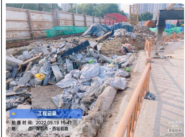
图 12 深圳市前海-南山排水深隧系统工程土建 I 标郑宝坑渠预处理站垃圾池未及时出运或覆盖。
