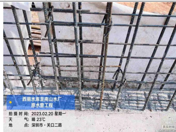
图5 西丽水库至南山水厂原水管工程钢筋接头在同一截面内，未按规定要求错开布置；钢筋接头未绑扎。
