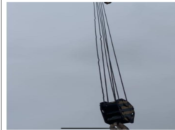
图8 丽水库至南山水厂原水管工程施工总承包履带式起重机的存在主钩副钩起升钢丝绳多处弯折。
