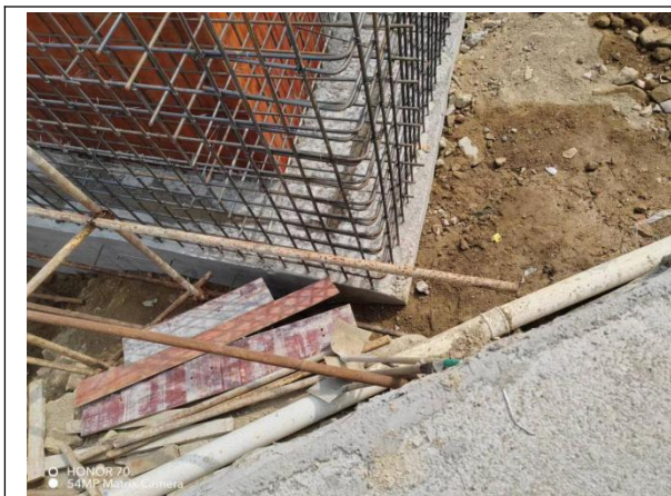
图2 三洲田水库供水消能及设施提升工程消力池已浇筑的混凝土底座基础线性不顺直，部分位置保护层厚度不足。
