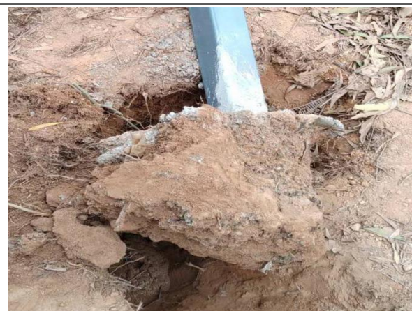
图3 赤坳水库一级水源保护区隔离保护工程已完工围网立柱基础（桩号 A5+357~A5+479），混凝土圆柱体土体下部混凝土深度不足且未扩大混凝土基础。
