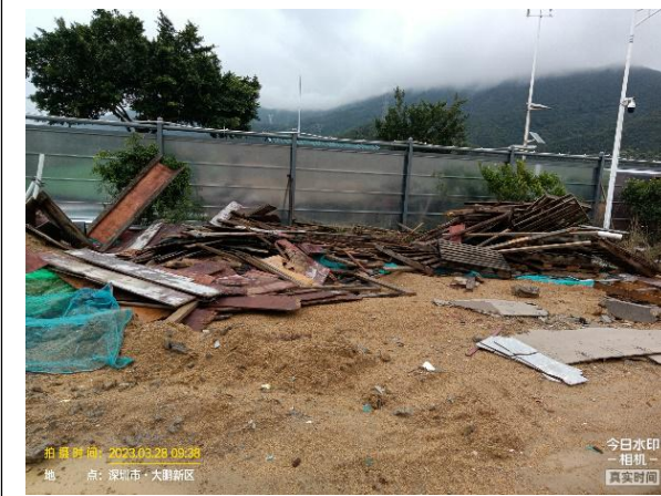
图11 径心水库附属设施隐患整治及环境提升工程现场材料堆放区材料堆放较乱,缺少标识牌及分隔措施;配备灭火器不足。
