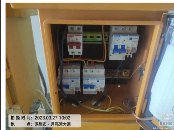
图9 深圳市前海-南山排水深隧系统工程机电装修I标郑宝坑预处理站现场部分开关箱内配置多个漏电开关。
