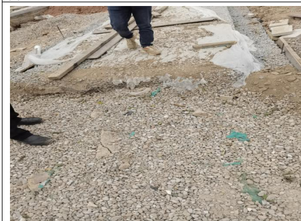
图4 大空港截流河沿河休闲带景观及2座人行天桥项目园路（电力三号井附近）有2处垫层使用再生料，与设计图纸要求的级配碎石不符。
