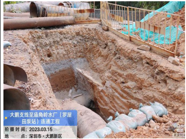
图7 大鹏支线至庙角岭水厂(罗屋田泵站)连通工程B段终点处基坑开挖深度达到3.7m,现场基坑边坡既未按设计图纸和施工方案要求进行钢板桩支护也未放坡。
