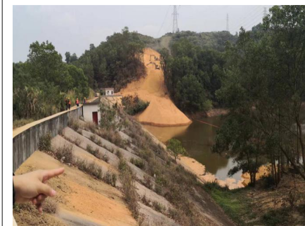
图10 公明水库-清林径水库连通工程公明取水口及配套交通工程已开挖道路边坡多处未做截排水措施,不能满足水土保持要求;施工现场多处扬尘防治措施不完善。
