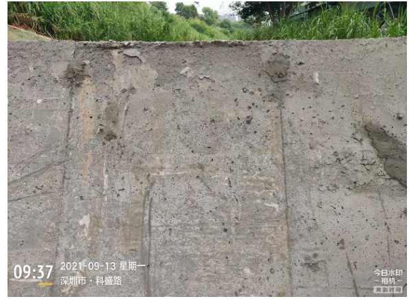
图3 观澜河流域（龙华片区）水环境综合整治项目-长坑水综合整治工程管涵端墙混凝土局部胀模、气泡麻面。
