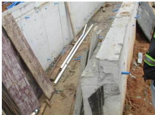
图4 大鵬河流域水环境综合治理工程（初雨处理设施除外）分洪沟已拆模段未覆盖养护，局部磕碰受损，对拉杆孔未及时清理。
