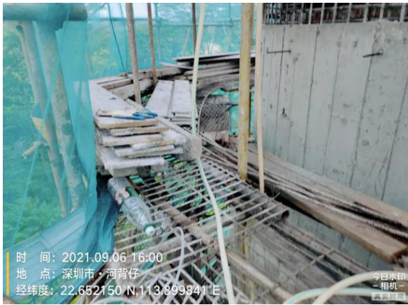
图10 深圳市供水网络铁岗-石岩支线铁石泵站调压塔改造工程脚手架缺少挡脚板、无防坠网,且临边放置大量模板和杂物。
