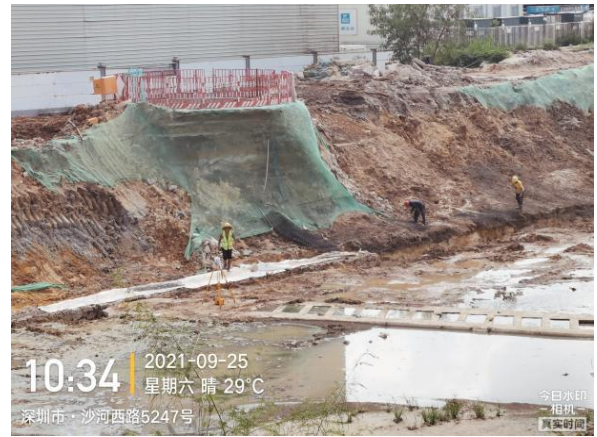
图11 南山区治水提质-白芒河流域水环境综合治理工程(水质保障工程)项目部附近河道土坡防止土石滚落措施不到位。
