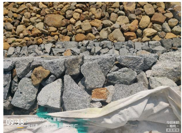
图7 金龟河小流域综合整治工程（设计采购施工项目总承包 EPC）田作沟旱溪干砌石护坡块石砌筑局部堵塞不密实，顶部块石局部未挤砌紧密。
