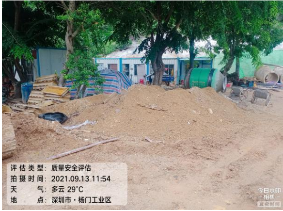
图8 麻坳河流域综合治理工程(初雨处理设施除外)石粉渣未覆盖。
