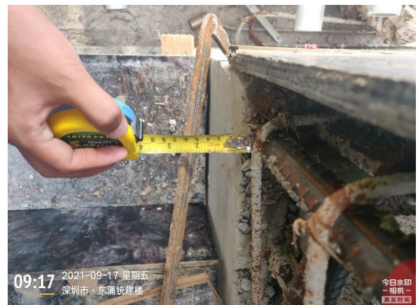
图5 东涌污水处理工程设计采购施工总承包（EPC）污泥脱水车间调理池池壁局部钢筋保护层厚度不足。
