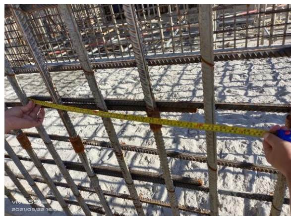
图6 大空港新城区截流河综合治理工程-主体部分（不含生态修复）北枢纽底层钢筋间距绑扎不均匀、局部间距大于设计要求。
