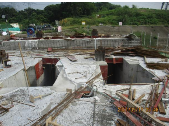
图12 深圳市公明水质净化厂二期工程设计采购施工总承包(EPC)现场局部临边防护,洞口防护缺失。
