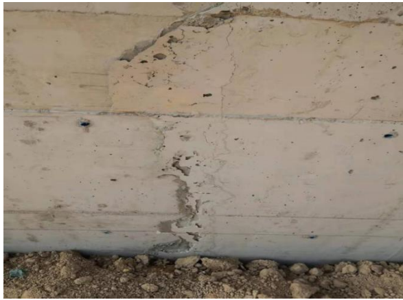
图2 打马坳水库除险加固工程主坝防浪墙外观质量较差，错台、跑模现象普遍。
