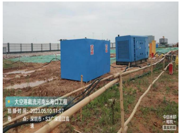
图 9 大空港截留河南出海口工程施工现场用于桩机作业的燃油罐设置在施工区域内。
