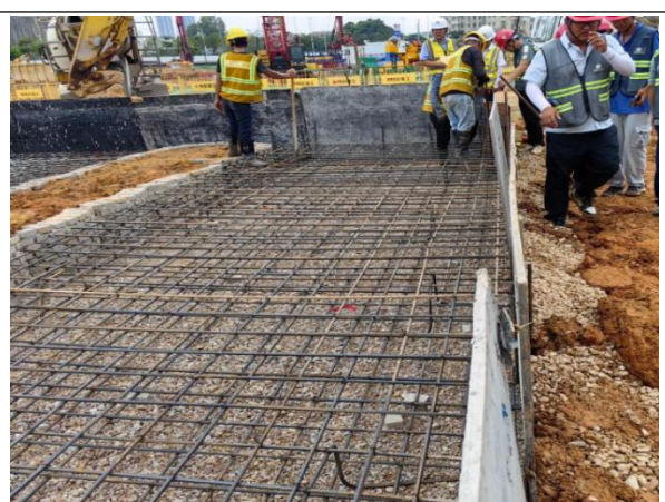
图3 宝龙水质净化厂咬合桩导墙(桩号G455~467)处安装的模板不顺直、稳定性差即已开始混凝土浇筑。
