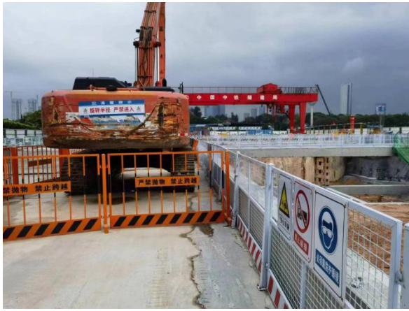
图 6 西丽水库至南山水厂原水管工程施工总承包现场挖掘机停放在提升泵基坑边不足 1m。
