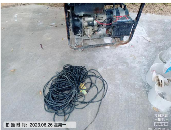
图 10 西丽水库前置库安全隐患消除工程现场发电机接电未使用配电箱，违规使用多孔插头，不符合三级配电两级保护。
