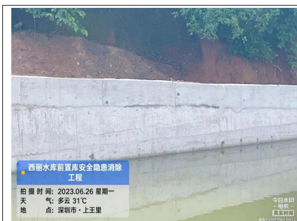
图2 西丽水库前置库安全隐患消除工程C区已浇筑的混凝土挡墙线型不顺直，局部错台。
