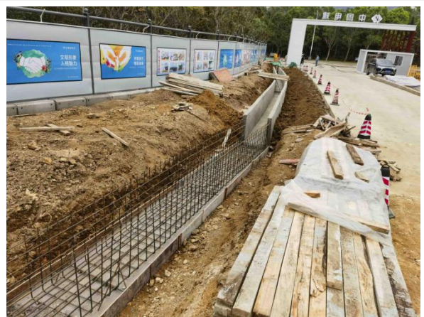
图5 深汕西部水源及供水工程-主体工程排水沟钢筋布置不符合设计要求，未设置沉降缝，钢筋接头在同一截面内。
