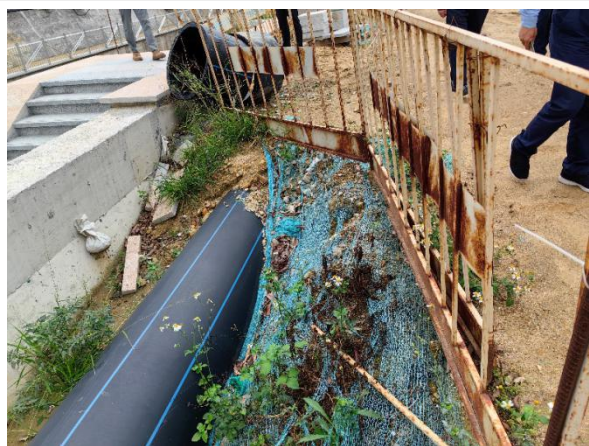
图4 王母河水环境综合整治工程桩号G4+300段补水管道未按设计要求回填（设计要求中粗砂+石粉渣回填），现场实际为原土回填。
