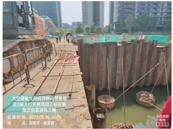
图 7 大空港新城区截流河综合治理工程沿河休闲带景观及 2 座人行天桥项目三标段景观及配套建筑工程栈桥部分临边防护措施缺失、护栏松动。
