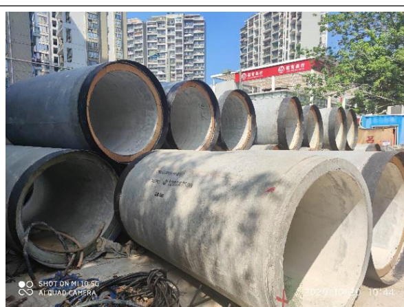
图8 福田区香梅路片区内涝整治工程8#工作井钢筋混凝土管材堆放高度过高。
