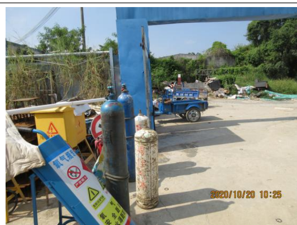
图12 观澜河流域（龙华片区）水环境综合整治项目-大布巷水综合整治工程氧气、乙炔未设置专库存放。
