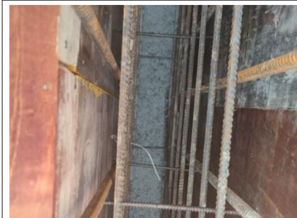
图3前海铁石片区水环境综合整治项目-共乐涌综合整治工程沿江高速公路段箱涵 F0+160-F0+180 段侧墙新旧混凝土衔接处未凿毛。
