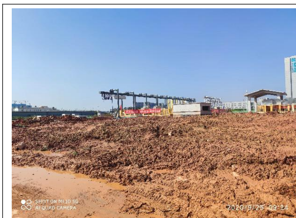
图7 茅洲河流域水环境综合整治工程-中上游段干流综合整治工程-上下村调蓄池工程现场裸露土未100%覆盖。
