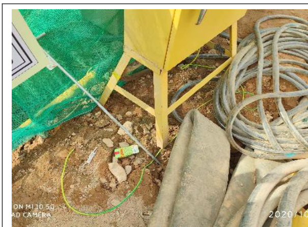
图9 深圳市布吉水质净化厂三期工程基坑内开关箱重复接地脱落（一处）。
