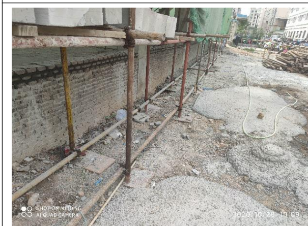
图11 大空港片区水环境综合整治项目-沙福河综合整治工程配电房现场外落地式钢管扣件脚手架局部横向扫地杆缺失。
