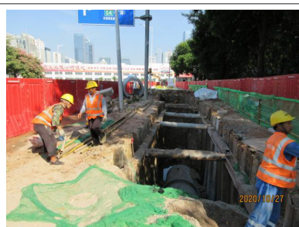
图10 福田区易涝风险区整治工程（2018年整治部分）白石路片区桩号Y17~Y18井段管道左侧临边防护栏杆未设置。
