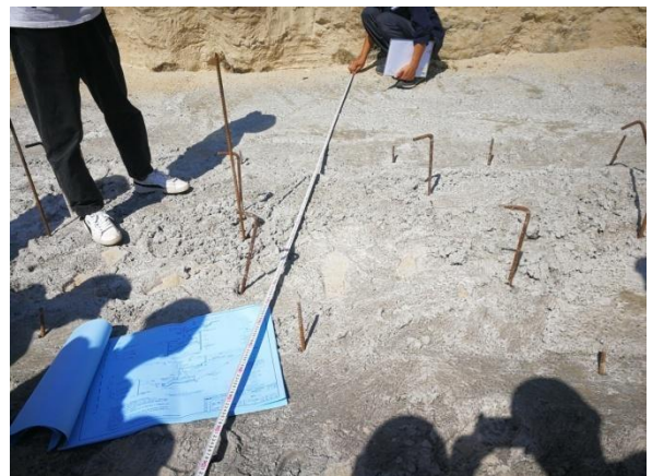
图6深圳市工人疗养院损毁海堤修复工程桩号K0+000-K0+22.6段挡墙基础顶部设计宽度为5m，现场实测宽度仅为3.6m。
