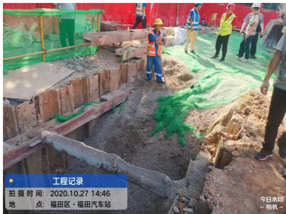
图5福田区易涝风险区整治工程（2018年整治部分）现场管道沟槽回填未分层并夯实。
