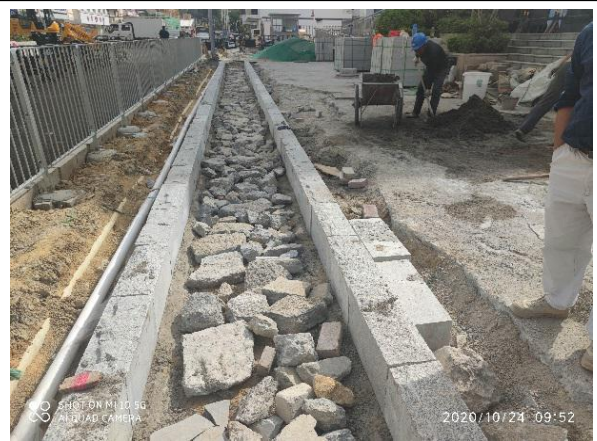
图4南澳河综合整治工程人民路南侧自行车道垫层设计要求为150mm碎石垫层，现场采用混凝土块、砖块加水泥石粉渣稳定层填缝代替垫层。
