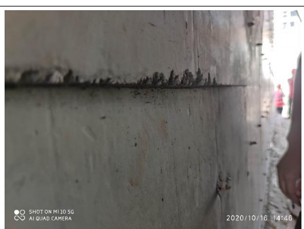
图 2 岗头河综合整治一期工程箱涵侧墙混凝土错台。
