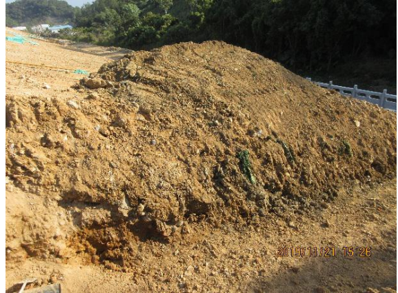
图 9 王母河水环境综合整治工程荷塘月色公园现场部分裸露土体未覆盖。
