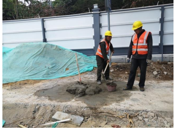
图 5 深圳市东部海堤重建工程（三期）堤岸配套工程（示范段）现场未按要求使用预拌商品砂浆，且违规采用人工拌和砂浆。
