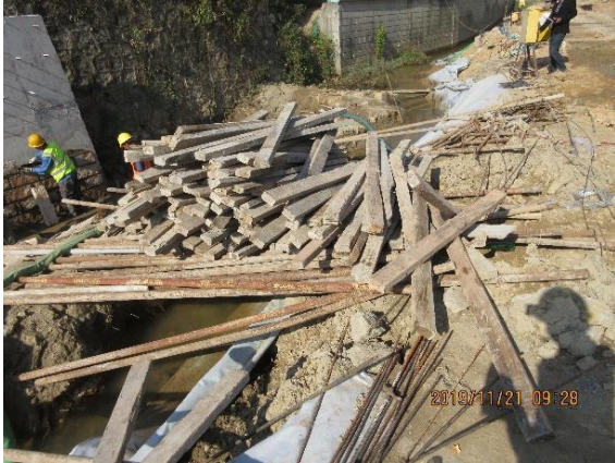
图 8 鹏城河综合整治工程现场模板木方堆放杂乱。
