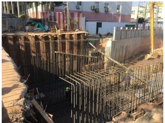
图 13 观澜河流域水环境综合整治工程-君子布河（龙岗段）综合整治工程河道岸墙支护均未按设计要求（ \Phi 299 无缝钢管横撑 \Phi 3000 ）设置横向对撑。
