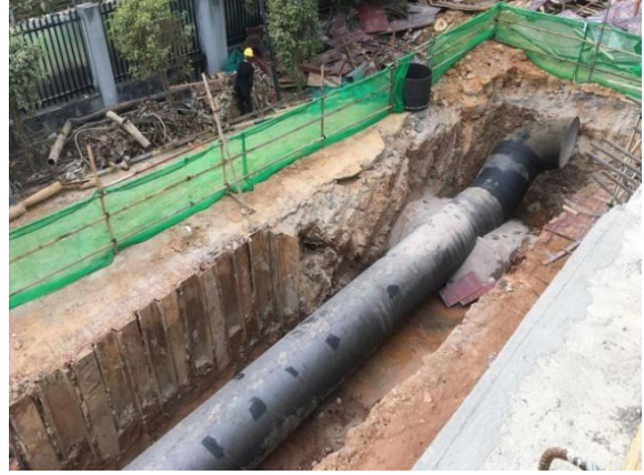
图 7 横岗水质净化厂二期提标改造工程消毒渠出水管沟槽底部未按设计要求铺设中粗砂即已安放水管。
