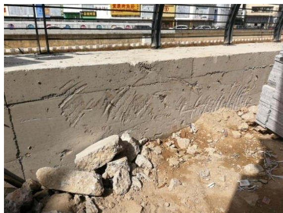
图 3 深圳市沙湾河流域水环境综合整治工程万润桥上游左岸段挡墙外观质量差，成品保护不到位，多处破损。
