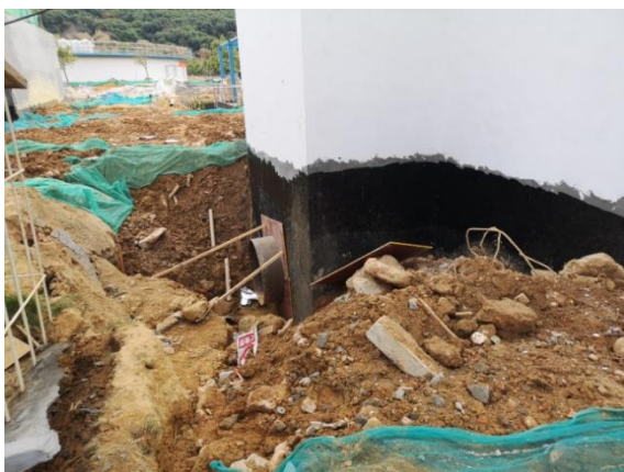
图 2 平湖水质净化厂提标改造工程提升泵房外侧回填料中夹带泥块、石块等杂物。
