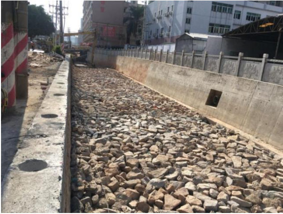
图 4 观澜河流域水环境综合整治工程-君子布河（龙岗段）综合整治工程河底干砌石铺砌不规范，现场存在石料铺砌不密实、平整度较差、大量浮石及通缝等质量问题。
