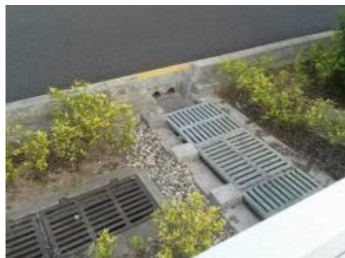
图 6-13 雨水滤存设施
