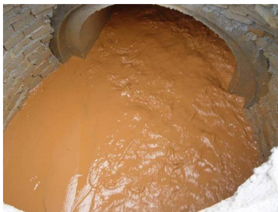
图 2-6 博深高速雨水管网淤积
